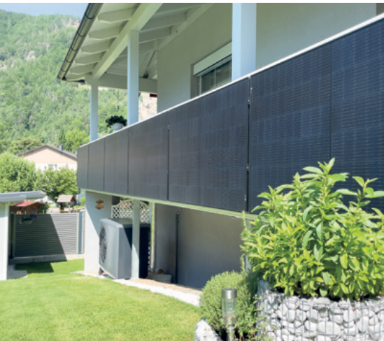
SONNENKRAFT PV-Balkon und Luftwärmepumpe
