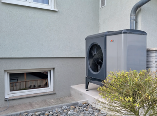
Außeneinheit einer Monoblock-Luftwärmepumpe
